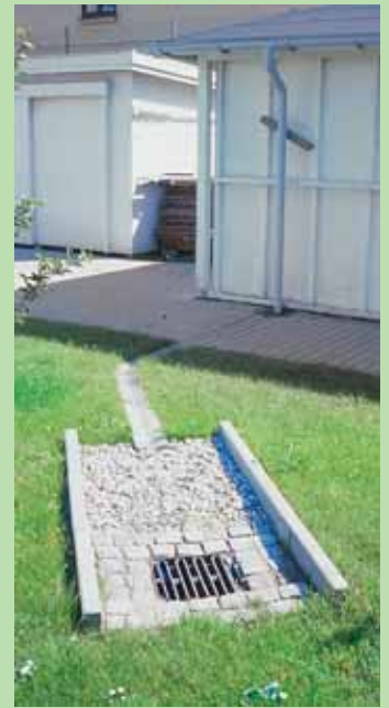
En enkel faskine med overløb til kloak. (Foto: Kim Tang)
